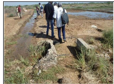
二次水路の様子。コンクリート構造物の多くは老朽化している
