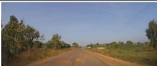
③N17 Revêtement en asphalte (Nombreux nids de poule)
