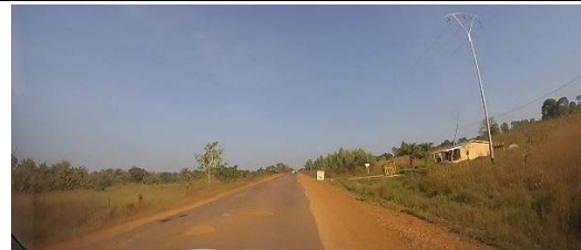
②N17 BP intersection Revêtement en asphalte (mal)
