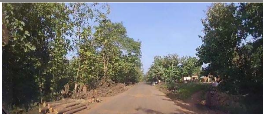
④N17 Revêtement en asphalte (Nombreux nids de poule)
