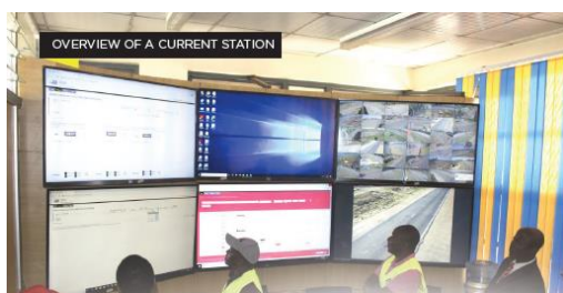
Centre de contrôle
