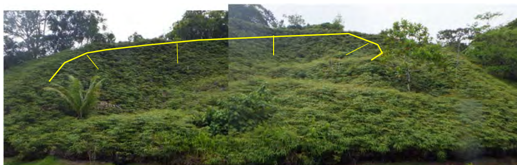
図 2.1.6 古い崩壊地跡（OC） 集水地形であること、再び崩壊する可能性が否定できないことから、直下部への電柱設置は避ける
