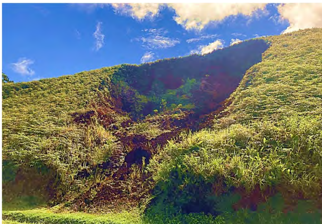
図 2.1.5 新しい崩壊地（RC） 植生が無く進行性の崩壊 この崩壊が分布する法面は全体に不安定であるため、電柱は反対側に設置する
