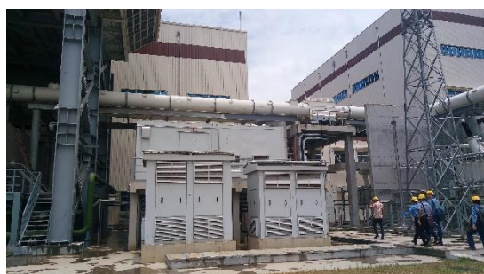
BPDB Ghorashal CCPP 設備状況調査 (2018.8.1)
