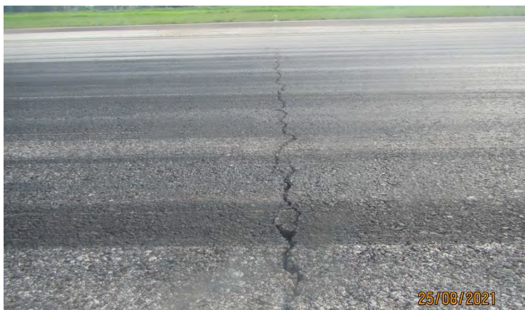
図 4.15 滑走路のひび割れの例
