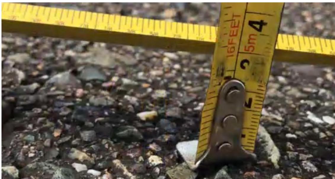
図 4.19 B 滑走路のわだち掘れ
