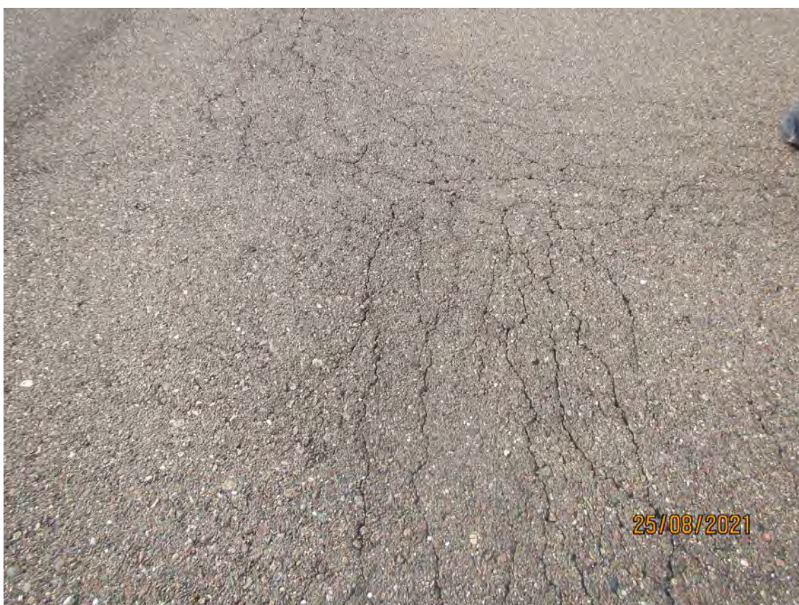
図 4.20 誘導路 T の亀甲状クラック
