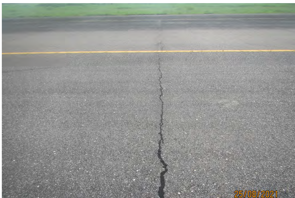
図 4.18 誘導路のひび割れ
