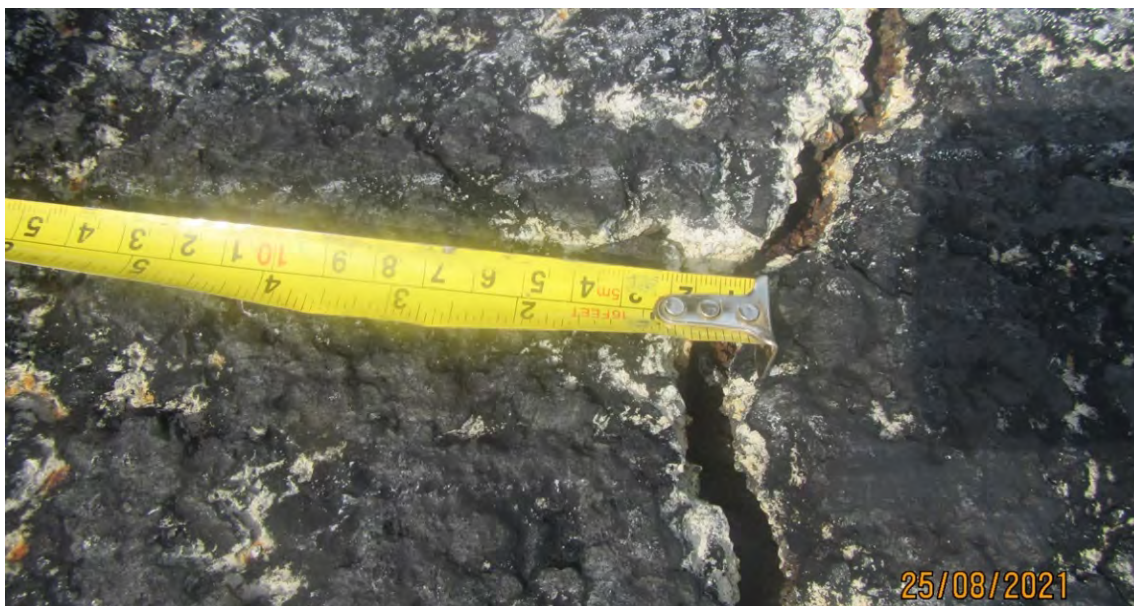
図 4.16 滑走路のひび割れの拡大写真
