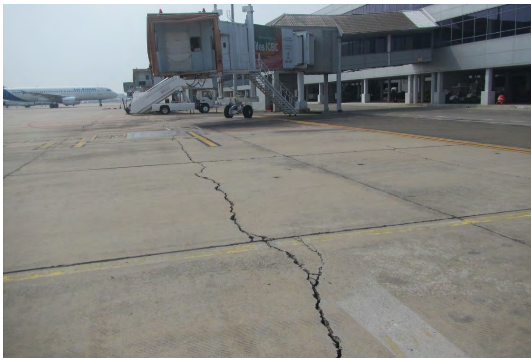
図 4.23 国際線旅客ターミナル前のエプロンクラック
