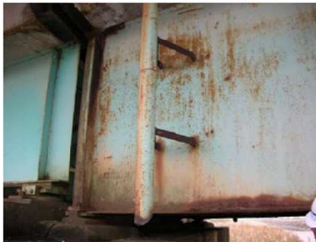
図 7.15 伸縮装置からの漏水による桁端部の腐食事例 90
