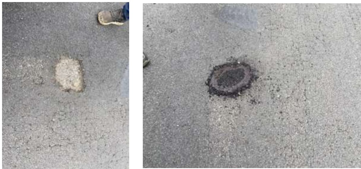
図 14.42 ポットホールの発生 (左) と補修 (右)
