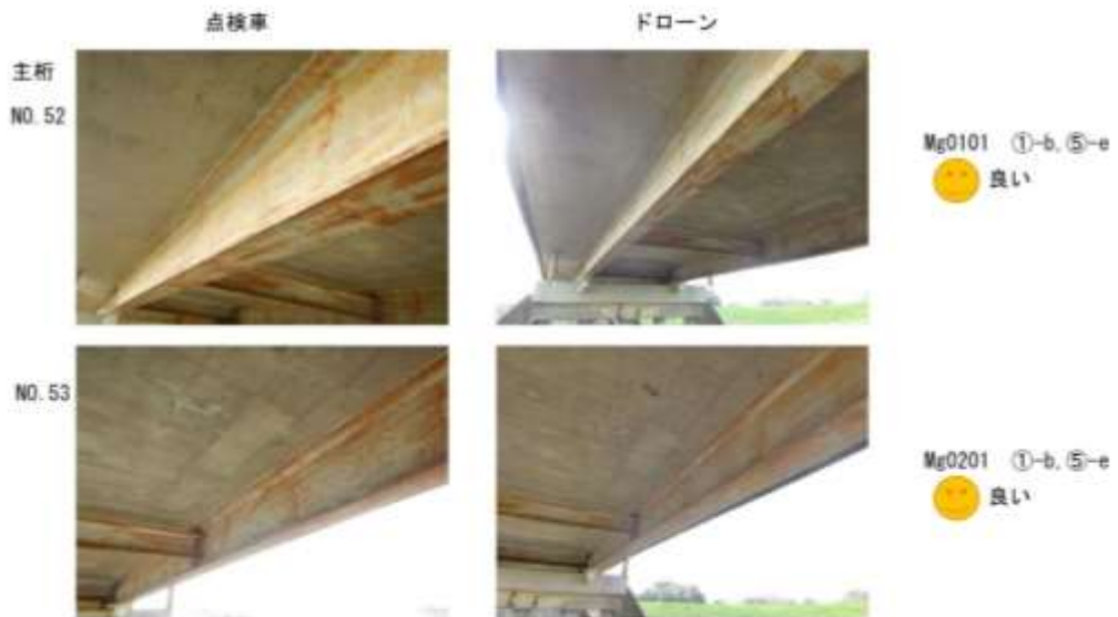
点検車から撮影した損傷写真とドローンで撮影した損傷写真の比較
