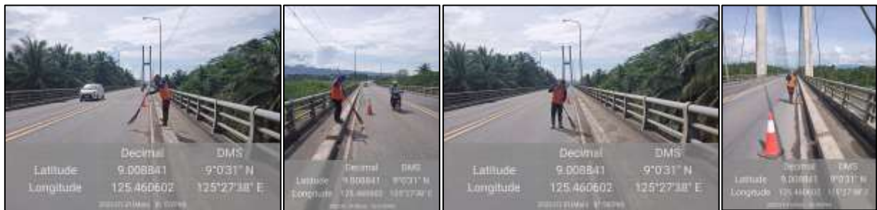
図 14.21 ディオスダド・マカパガル橋における清掃の実施状況
