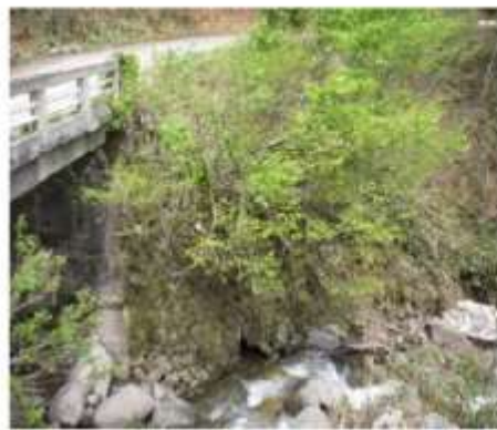
現況は老朽化した桁橋
