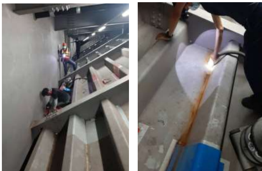
図 14.41 鋼上部工内部における鋼材の腐食
