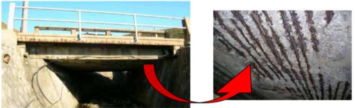
図 7.16 塩害による損傷事例 91
