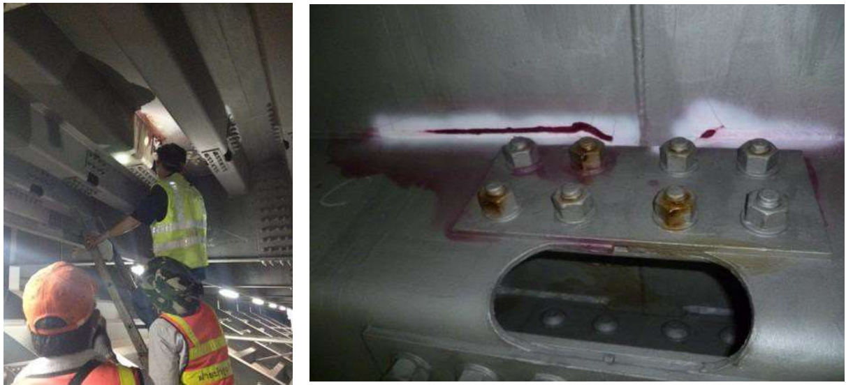
図 14.44 鋼床版と U リブ補強材のクラック
