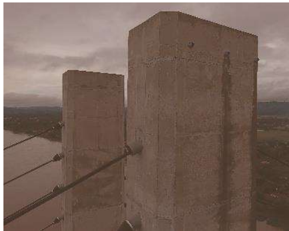
図 14.24 主塔部ケーブルカバーの脱落
