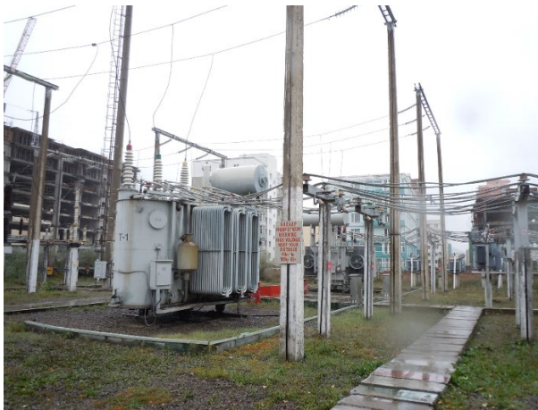
既存変電所の変圧器と母線
