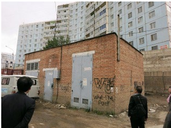
配電塔の外観
