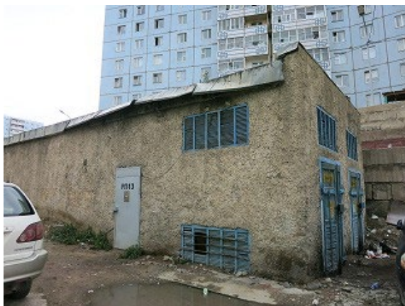
開閉所の外観
