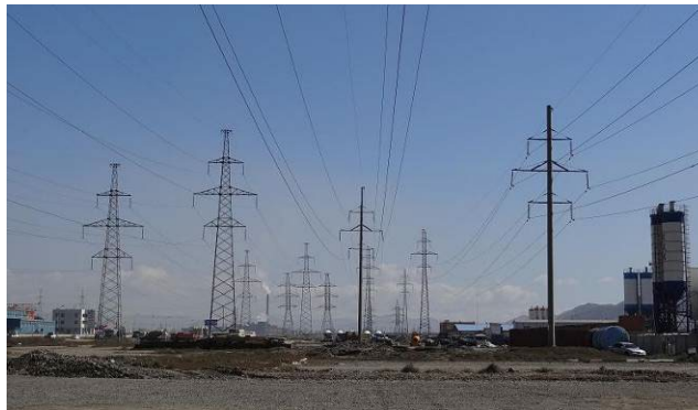
図 3-4 ウランバートル第4火力発電所近傍の架空送電線
