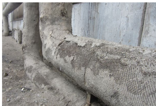
保温劣化が進んだ温水配管
