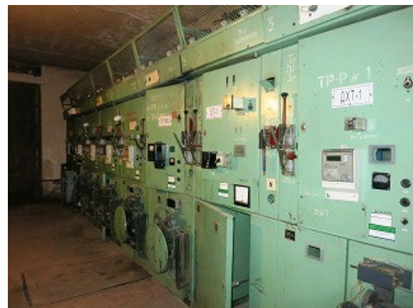
開閉所内部の遮断器
