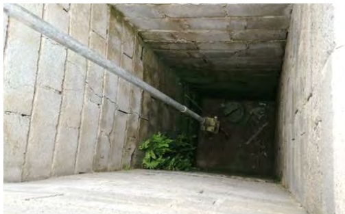
Jono Oge 頭部 掘抜井戸（震災後） 住人からのヒアリングでは、GL-1～GL-3m に水位があったとの情報である。震災後は、井戸底まで水がなくなっている。 これ以外にも、Petobo・Sibalaya の井戸において同様の井戸枯れが確認されている
