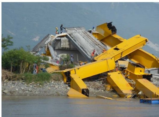
Collapsed Jembatan Palu IV
