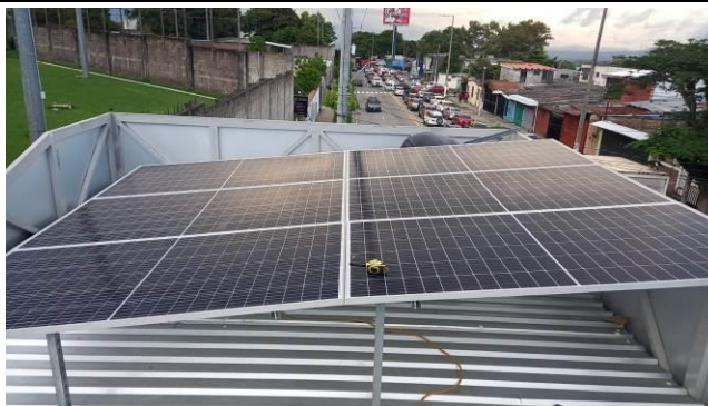
Paneles solares en la torre del tablero de información en dirección Sur/San Salvador (octubre de 2021)
