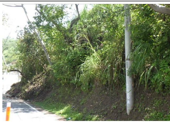
2021 年 9 月 10 日に生じた地すべり末端の道路へ押し。 起点側から撮影 (2021 年 9 月 16 日)
