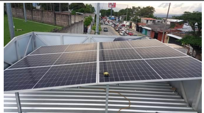
南/サンサルバドル方向の情報板タワーの太陽光パネル (2021 年 10 月)
