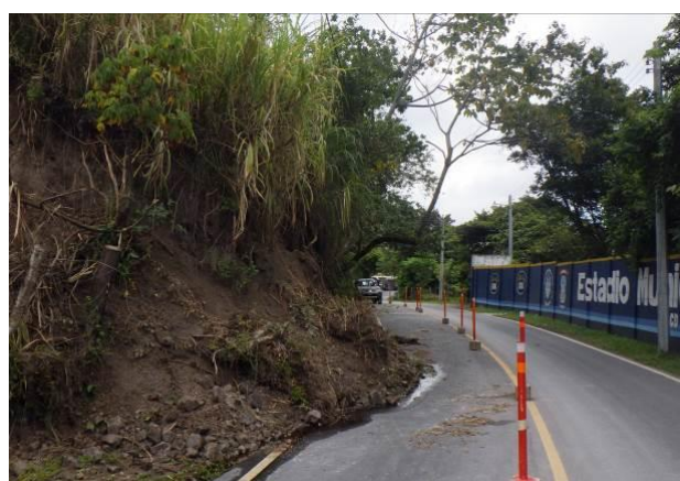
2021 年 9 月 10 日に生じた地すべり末端の道路へ押し 出し。終点側から撮影 (2021 年 9 月 16 日)
