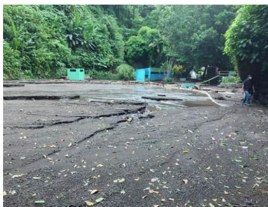
同上、流出土砂は礫交じり砂質土 (2020 年 6 月 6 日)
