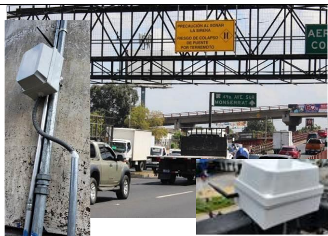
高架橋の上り口に設置した強震時警報情報板と、強震情報通信施設 (2020 年 3 月)
