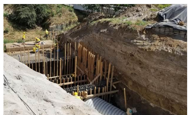
公共事業運輸省 (MOPT) による IDB 借款の持続的都市冠水対策事業の施工状況視察(2020年2月)
