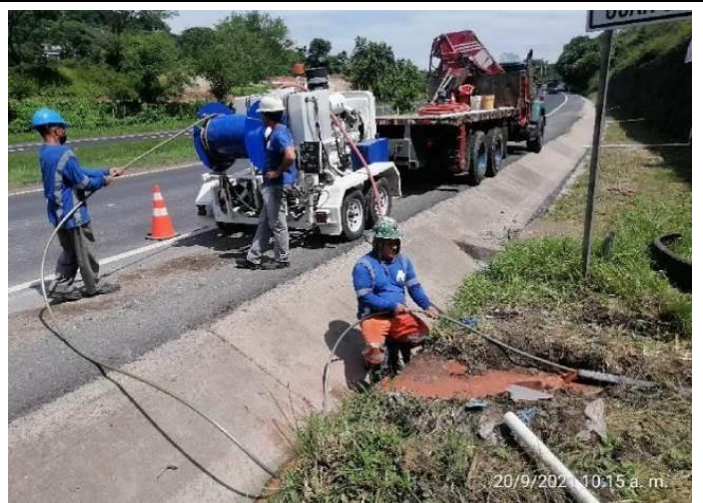
既往の地下水排水孔の注水洗浄、褐色の古土壌から生じた濁水の排水が認められる (2021 年 9 月)
