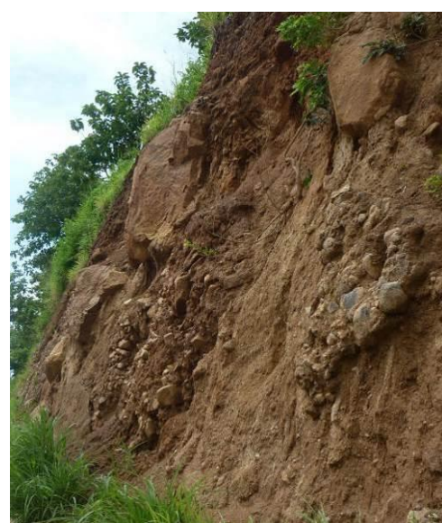
大礫から巨石を含む土砂斜面、一部オーバーハングしている。(2021 年 4 月)
