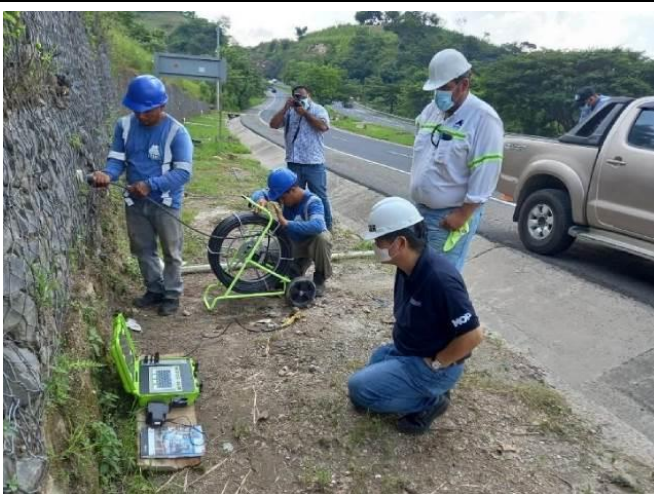
既往の地下水排水孔の孔内ビデオ撮影 (2021 年 9 月)
