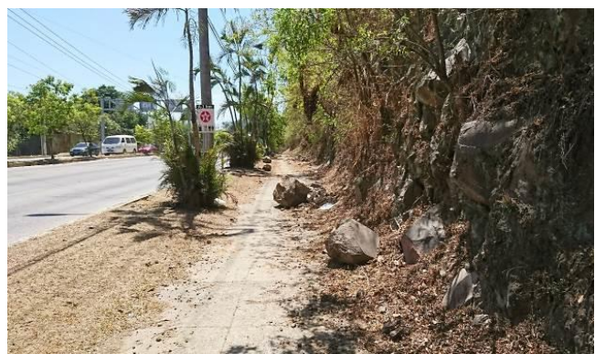
落石頻発箇所、歩道と車道を保護する、高エネルギー吸収型落石防護柵を施工する区間 (2020 年 2 月)
