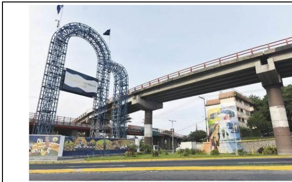
写真奥のモニュメント近傍の橋脚、高さ 12m、橋軸方向の落橋防止構造が不在(2017 年 9 月)
