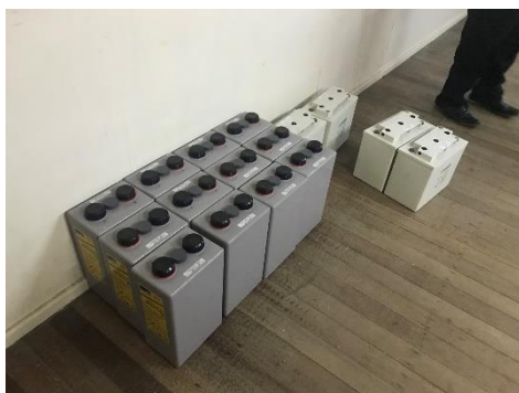
（研修用蓄電池）
