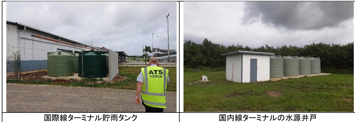
図 4-2-13 ファアモツ国際空港の給水施設
