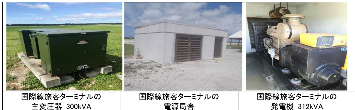
図 4-2-9 ファアモツ国際空港の電力施設
