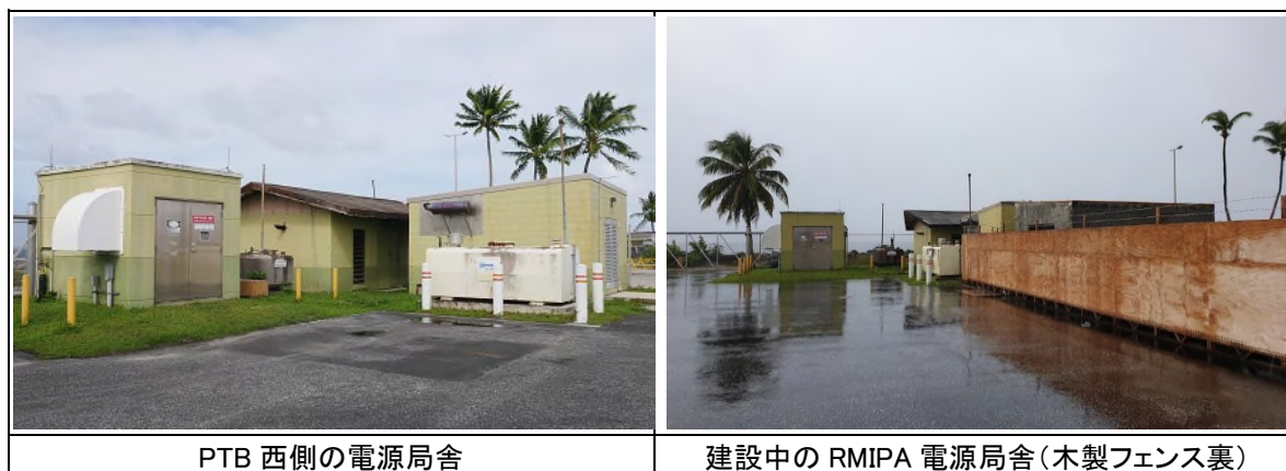
図 4-1-7 既設の電源局舎
