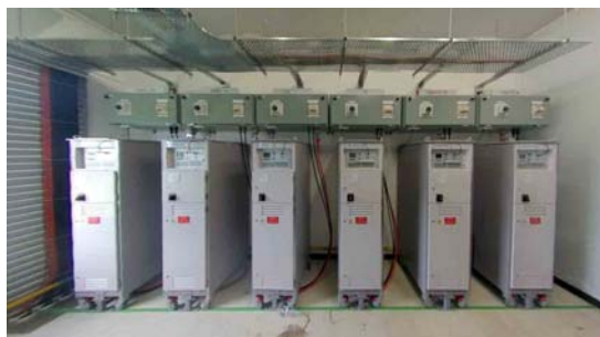
写真 3.15 航空灯火制御盤
