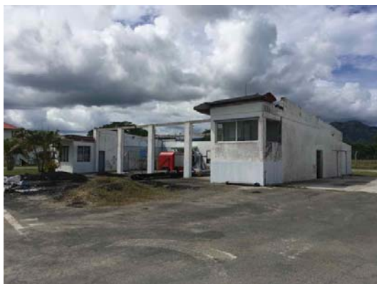
写真 3.11 サイクロン・パムで損傷した 消防署
