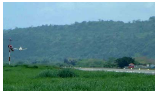
写真 3.16 航空灯火(滑走路灯の点灯)
