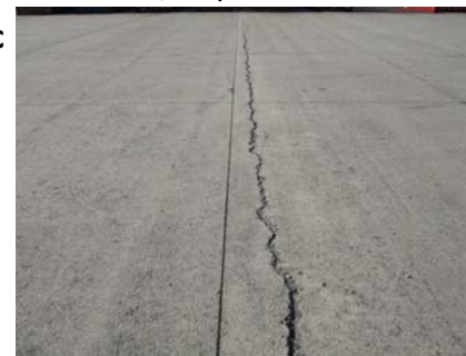
Трещины возле вертикальных швов
