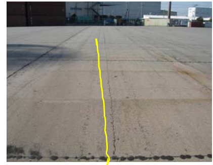
Вертикальные трещины в центре плиты
