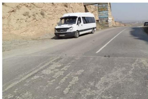
Фото 1: участок начала и окончания строительства УУБП Правая сторона: конец предыдущей полосы (плохая отделка)
