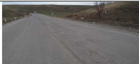
Фото 2: общие условия отделки Разделение материала, дефект отделки вертикального шва
