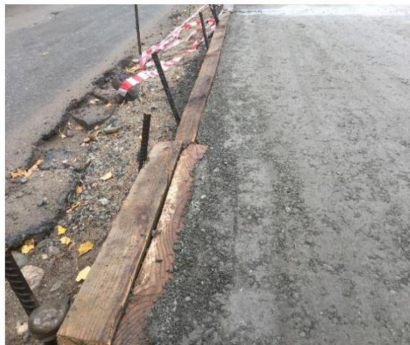
Шероховатость, образованная из-за ненадежной установки опалубки при строительстве 1-полосы
