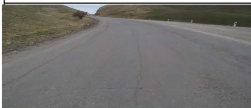
Фото 3: Структурная вертикальная трещина при расширении внутренней кривой
