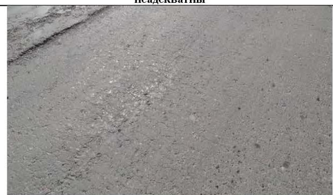
Фото 4: разрыв трещины Плохая консистенция УУБП (слишком много воды)
