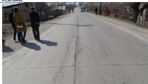
Фото 3: плохая отделка на конце тротуара Скользкий метод / завершение работы человеческий фактор недостаточно
