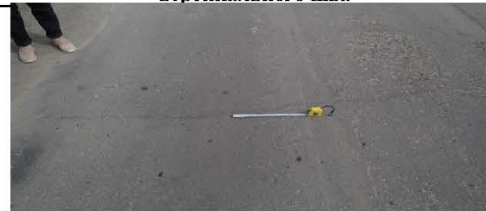
Фото 4: Начальная температурная усадка трещины
