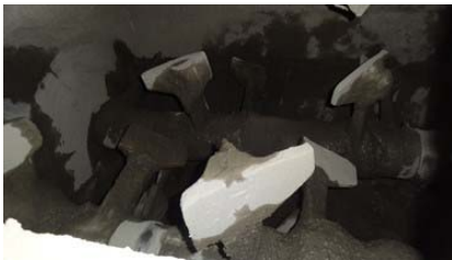
パグミルミキサー内（定期清掃あり）
