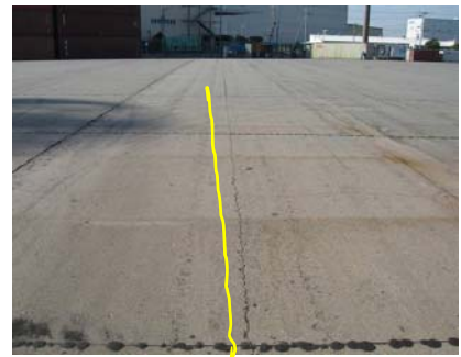
版中央部の縦ひび割れ
