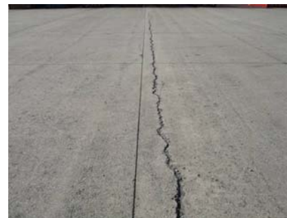
縦施工目地近傍のひび割れ
