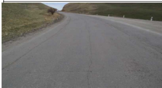
写真3：内カーブ拡幅部での構造的縦クラック
