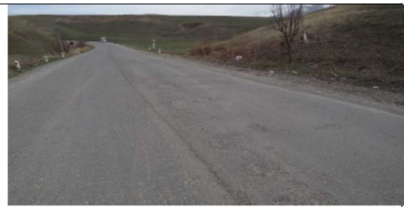
写真2：一般的な仕上がり状況 材料分離、縦継目部の仕上げ不良
