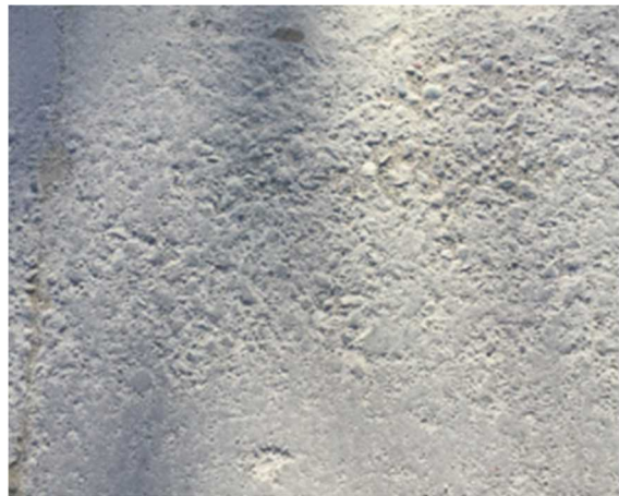
現時点で安定した粗面状況
