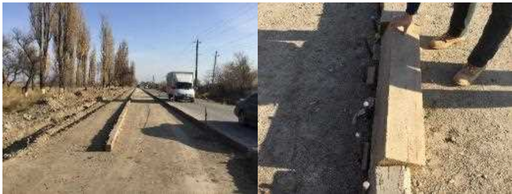
2車線目施工に係る型枠設置完了状況（型枠が容易に移動する状況にある）
