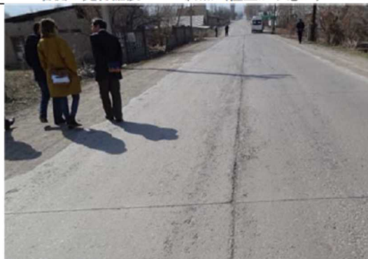
写真3：舗設端部の仕上がり不良 転圧方法/端部人力補助作業不十分
