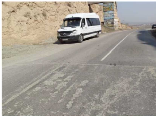
写真1：RCCP 施工始終点部（緩急路上部） 右側：先行舗設レーン終点（仕上がり悪い）
