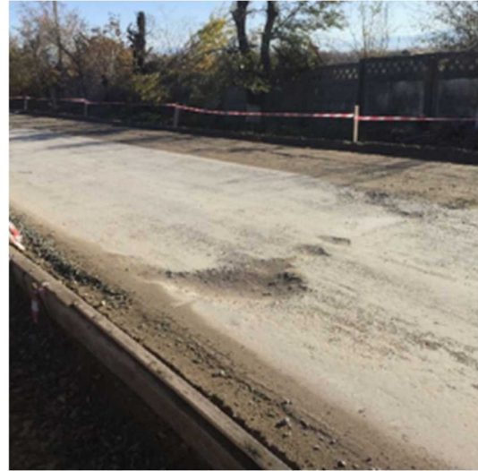
ポットホールの発生状況
