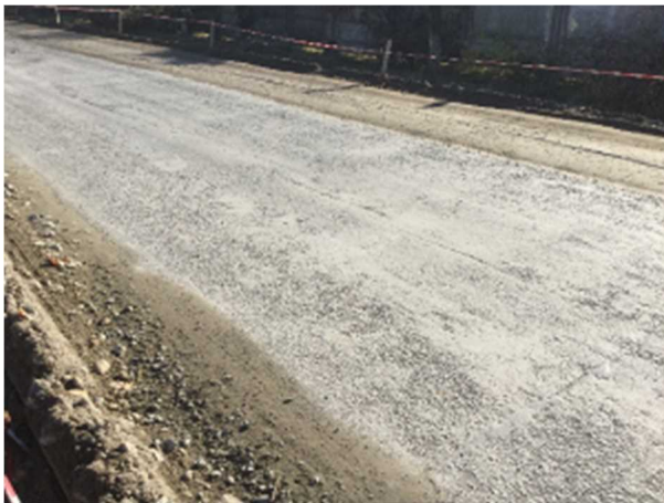
道路表面の粗面およびスケーリング化状況
