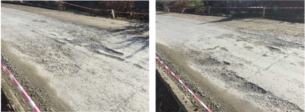
ポットホール化状況
