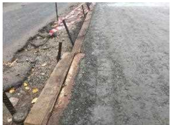
1車線目施工時の型枠設置不良による型枠際の粗面状況
