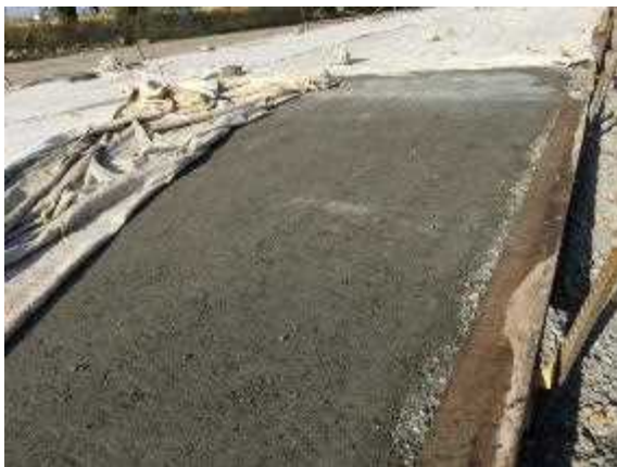
型枠際でモルタルが粗骨材に付着せず粗面となっている
