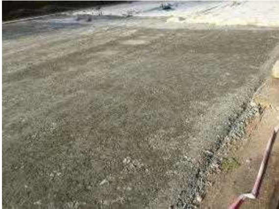
道路の全面の一部および型枠際に粗面が見られる
