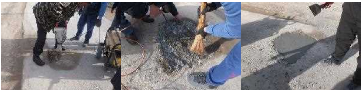
1車線目の施工不良（ポットホール）の修復状況
