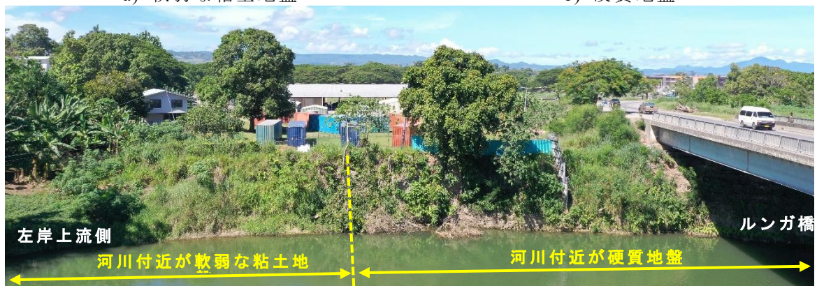
図 3-72 洗堀箇所の状況写真（ルンガ橋より上流側・左岸側）
