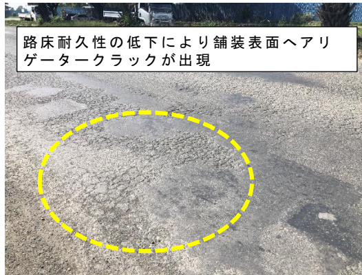
図 3-13 路床耐久性の低下による舗装表面の損傷
