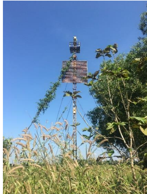
既存タンリンポイント灯台 後灯 (状態が悪いため建替え)
