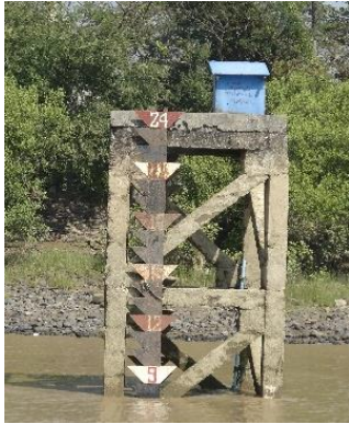
モンキーポイント潮位観測標 (2017年12月の崩壊前) (新規気象海象観測所設置予定地)
