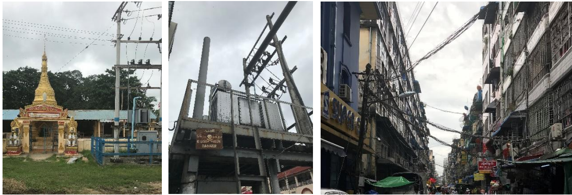
ミャンマーの変圧器（左：ネピドー郊外の村，中央：ヤンゴン）と配電線（右：ヤンゴン）
