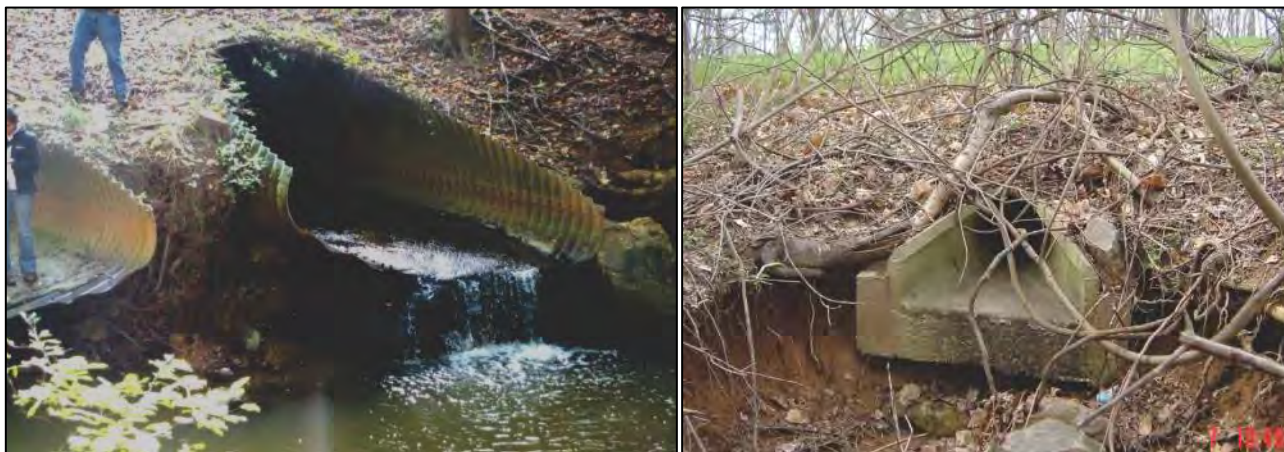
Figura 9.1 — Ezemplu erosaun iha culvert nia outlet (7)
