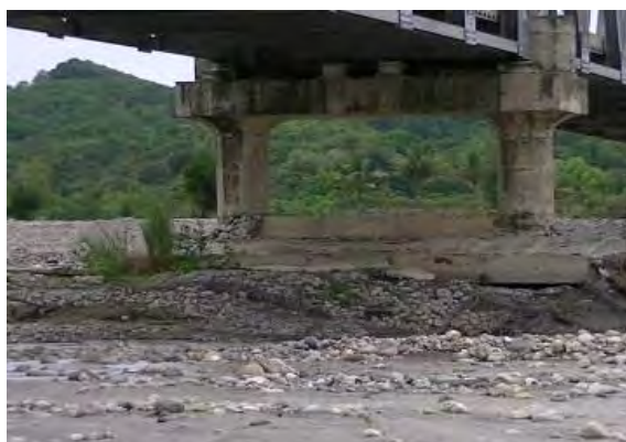
Figura 20 — Gabion ne'ebe hetan estraga iha Ponte Mola 2011
