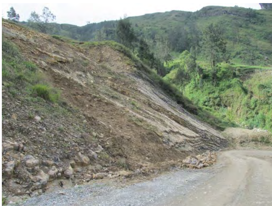
Figura 6 — Kolapsu relasiona ho corte de taludes
