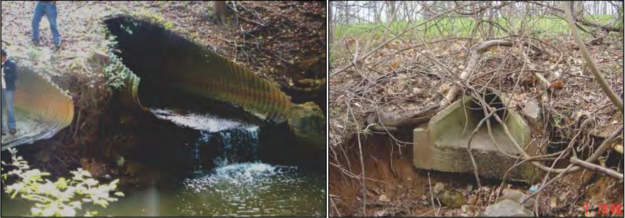
Figura 9.1 — Ezemplu erosaun iha culvert nia outlet (7)
