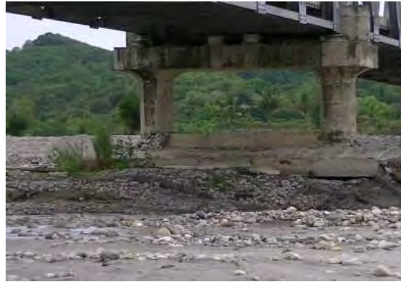
Figura 20 — Gabion ne'ebe hetan estraga iha Ponte Mola 2011
