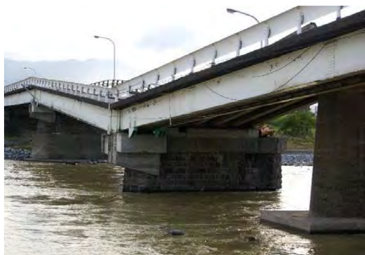
Figura 6 — Penurunan ponte tamba pilar ponte ne'ebe hetan scouring (Ezemplu iha Japaun)
