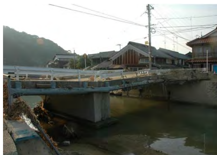
Figura 7 — Penurunan ponte tamba pilar ponte ne'ebe hetan scouring (Ezemplu iha Japaun)
