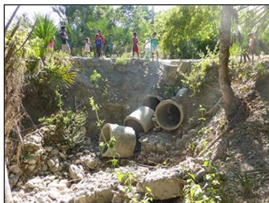
横断排水施設の損傷状況（Sesurai）
