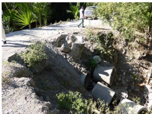
A05 道路構造被害（Sesurai）
