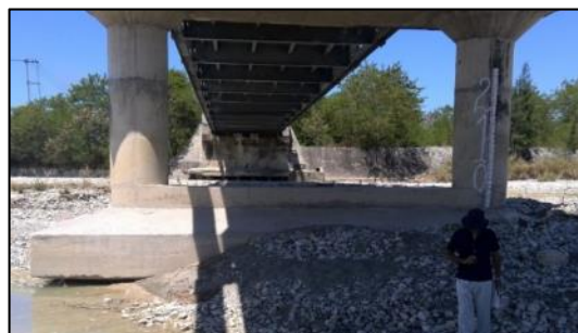
橋脚下の洗堀（Sahen 橋）
