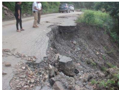
A03 道路構造物損傷（Likisá）
