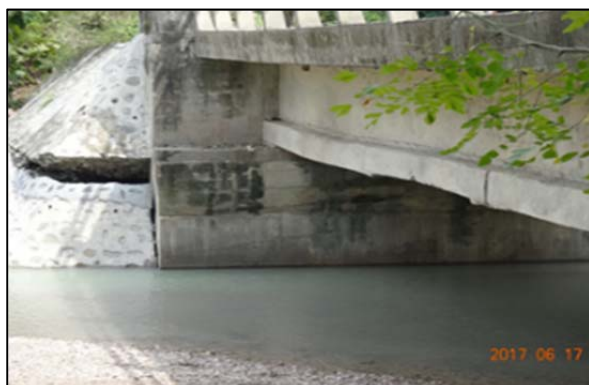
橋台下の洗掘（Kelan 橋）
