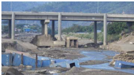
既設橋梁下部工被災状況
