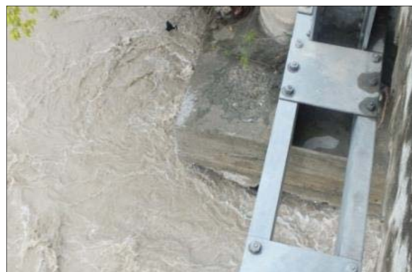
橋脚下の洗掘（Sarai 橋）
