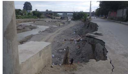
擁壁被災状況
