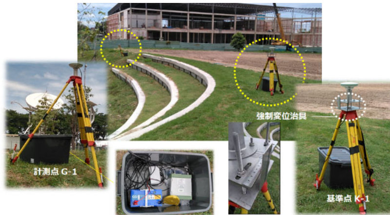
図 33 社会実験用機材のセットアップ
