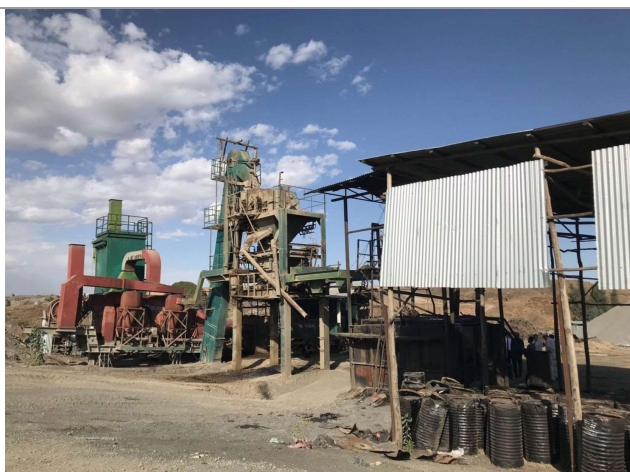
写真 7 : アスファルトプラント
