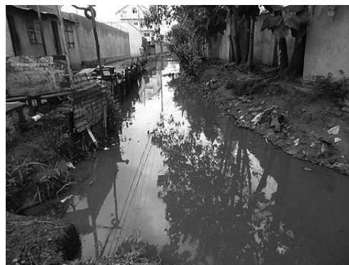
Photo 9 Dégradation des canaux existants
