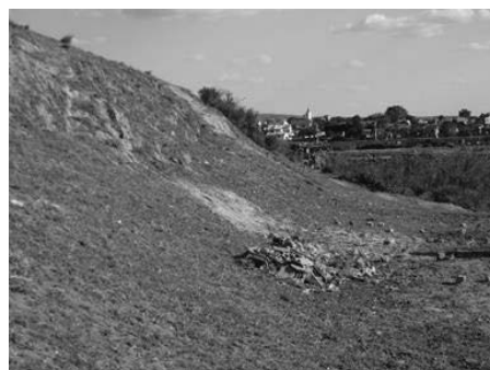
Photo 2 Une digue qui doit encore être renforcée (rivière Sisaony)
