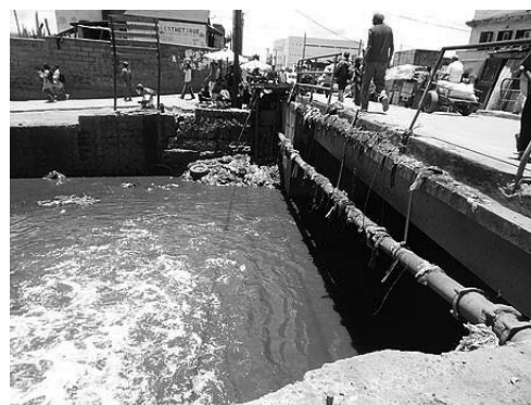
Photo 5 Déchets interférant avec l'écoulement près des structures
