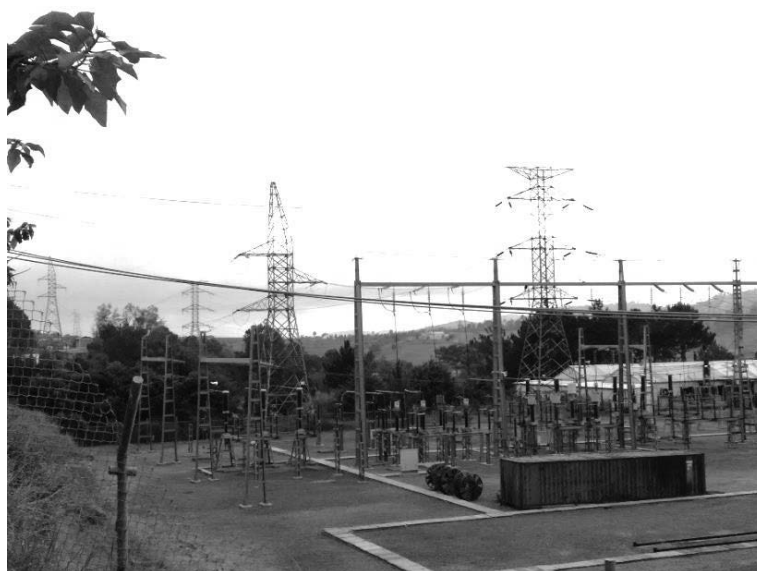
Figure 11.1.6 Lignes de transport existantes (à droite : 138 kV, à gauche : 63 kV)
