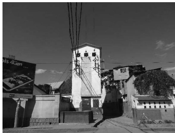
Figure 11.1.10 Sous-station de 35 kV/380 V
