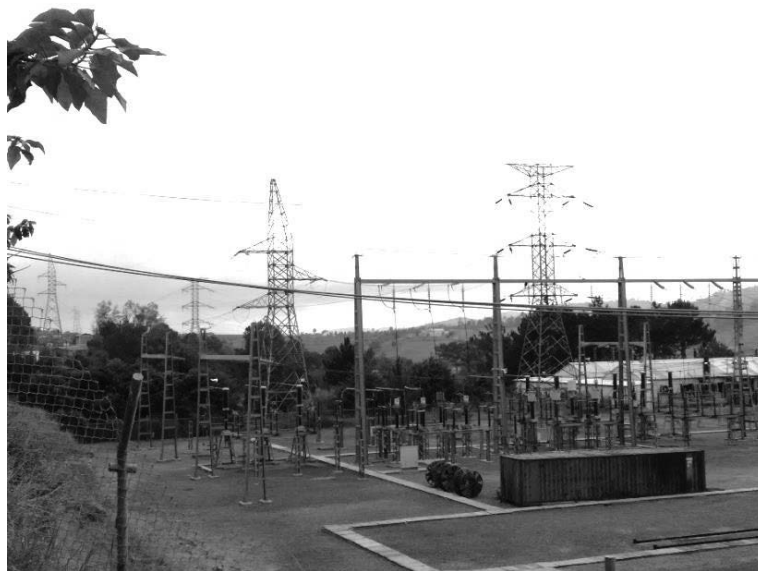
Figure 11.3.6 Lignes de transport existantes (à droite : 138 kV, à gauche : 63 kV)
