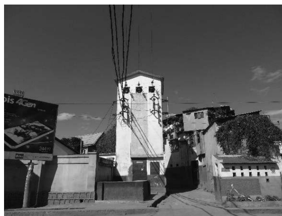
Figure 11.3.10 Sous-station de 35 kV/380 V
