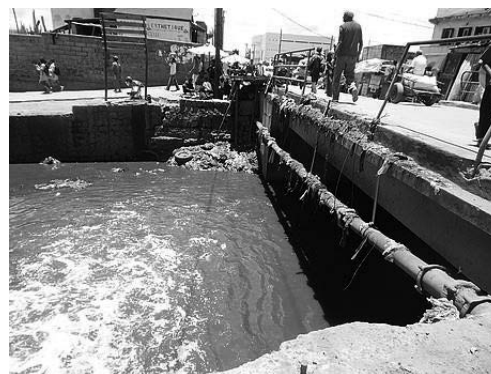
Photo 5 Déchets interférant avec l'écoulement près des structures
