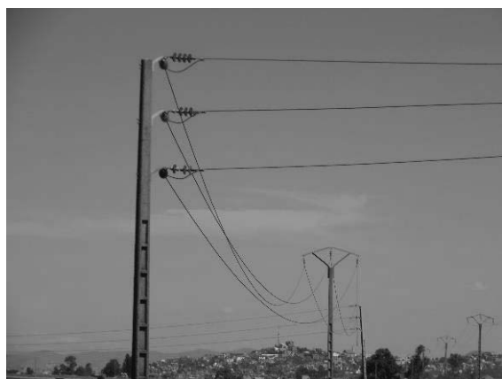
Figure 11.3.9 Ligne de distribution de 35 kV
