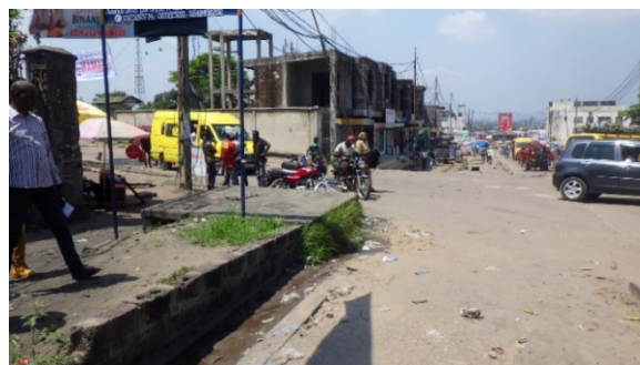
Fossé latéral enterré par débris au drainage croisé à PK6,5 km à côté droit
