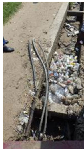
6,6 KV apparatus à PK9,3 km à côté gauche le 28 novembre 2018
