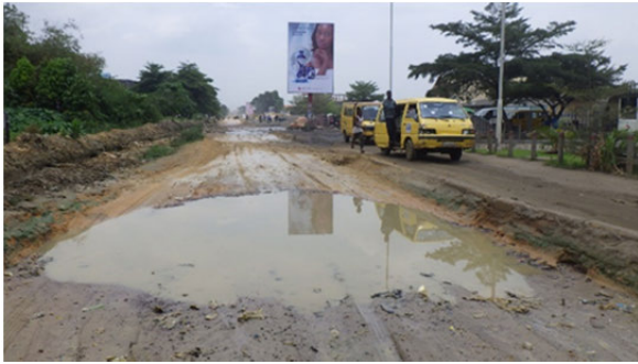
Flaque d'eau dans l'actuelle route à environ PK2,0 km
