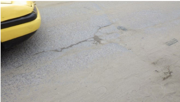
Fissures à cause du niveau élevé de la nappe phréatique aux environs de PK5,5 km
