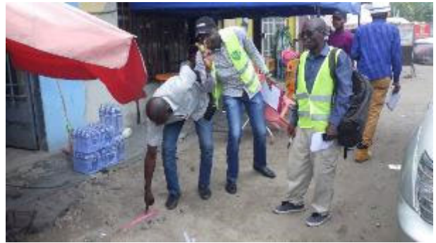
Câble de la SNEL 6,6KV apparu à côté droit PK0,44 km le 16 novembre 2018
