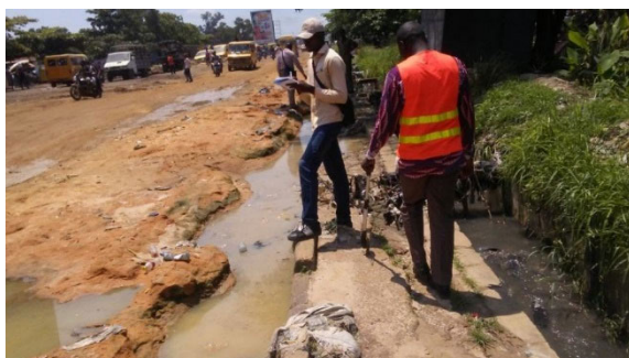
Caniveau obstrué (à droite)
