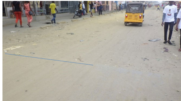
Chaussée détruite à cause du niveau élevé de la nappe phréatique
