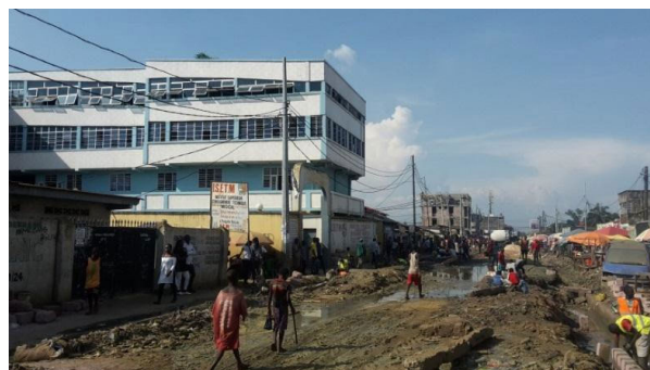
Eau stagnante sur la route
