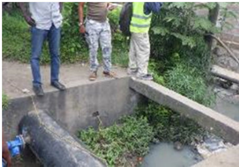
FD500mm et AC100mm apparu à côté droit PK0,65 km le 16 novembre 2018
