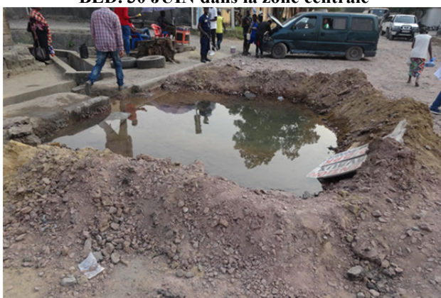
TABU LEY dans la zone centrale (Fuite d'eau)
