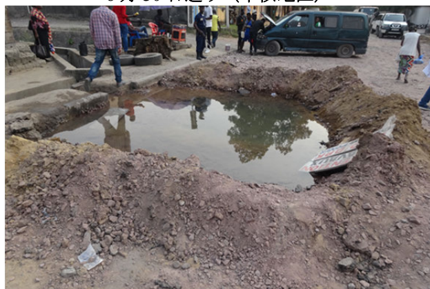
Tabu Ley 通りにおける漏水 (中核地区)
