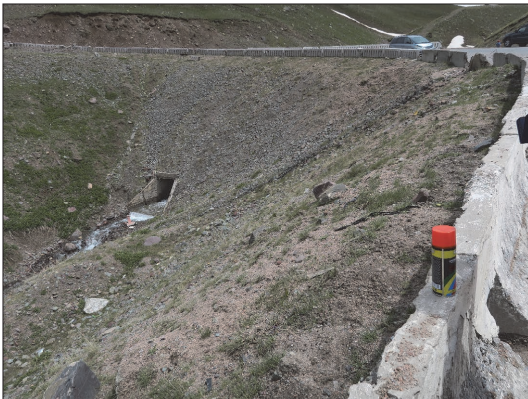
写真 2-2-8.6 視線誘導柱設置箇所の路肩の確認 (Ala-Bel 峠 : KP217+300 付近の路肩の様子)
