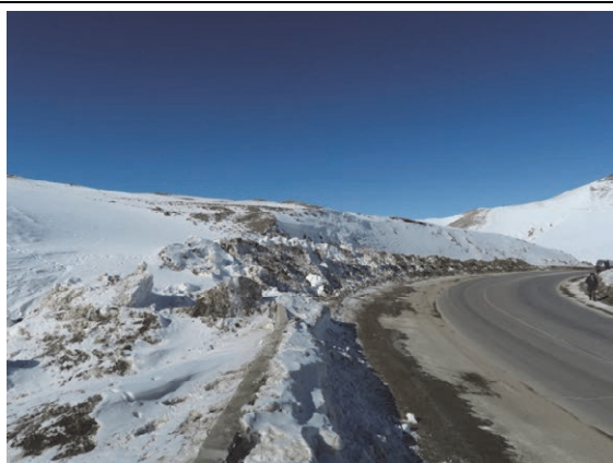
KP215+900 カーブ区間の終点側の切土斜面には吹きだまりが生じた痕跡がある
