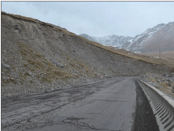
KP 127+400 大きな切土斜面が道路に迫り、吹きだまりの発生が考えられる。
