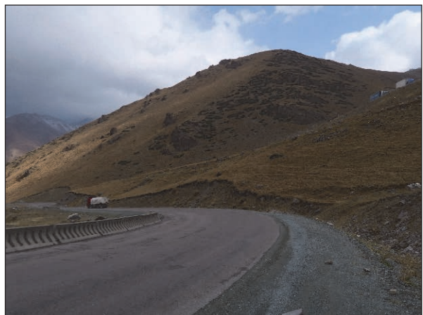
KP 126+250 切土が連続し、その上部には平坦な山地斜面が広がり、地吹雪の発生要因となっている。
