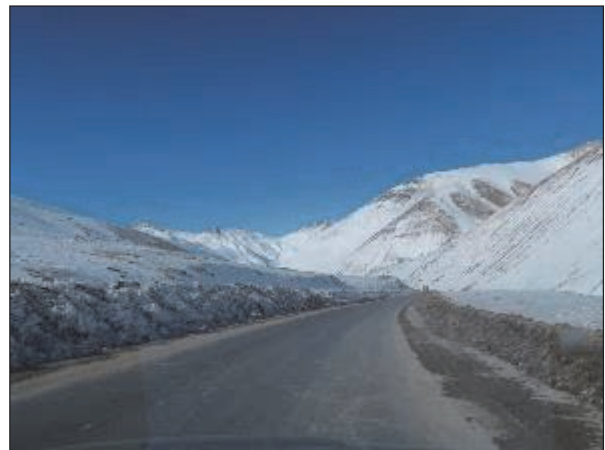
道路の山側から吹きだまりが発生した可能性がある (図 2-2-4.4 (2)の m)。
