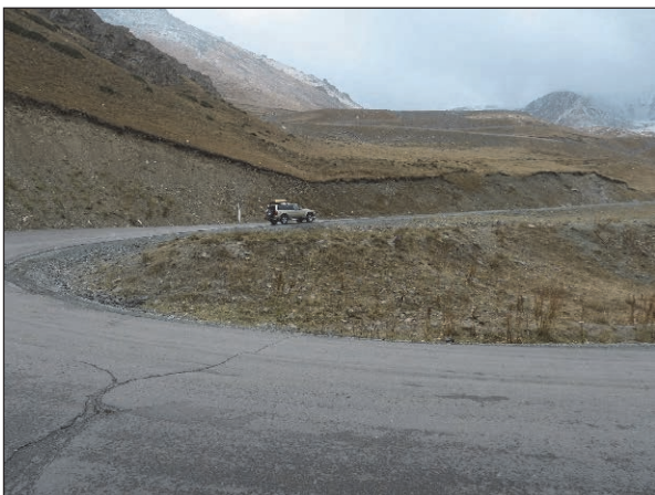
KP 125+850 南方向に平坦地が広がり、切土斜面でもあり、地吹雪による吹きだまりの要因となる。
