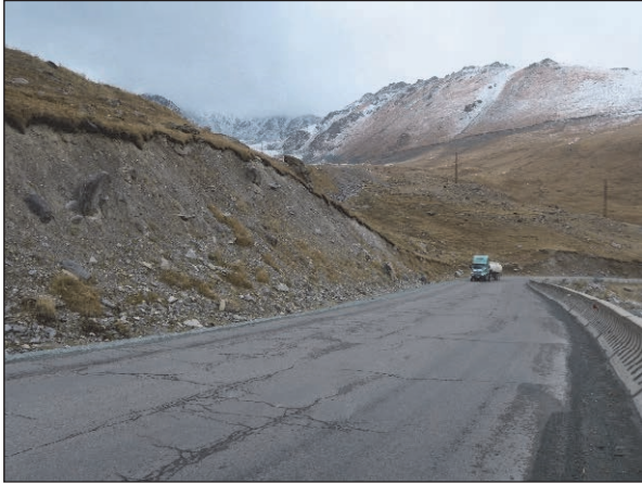
KP 126+600 大きな切土斜面が道路に迫り、吹きだまりの発生要因となっている。
