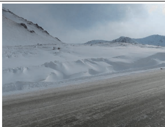
KP128+300 風上側の平坦地から発生した吹きだまりが道路側に成長している
