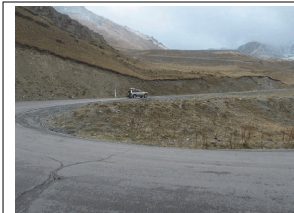
KP125+850 南方向に平坦地が広がり、切土斜面でもあり、地吹雪による吹きだまりの要因となる
