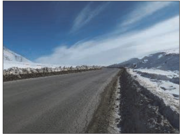
路側の切土斜面に吹きだまりを生じた痕跡がある（図 2-2-4.4 (1)の g）。
