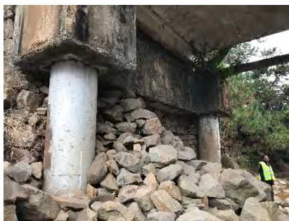
杭基礎の露出
