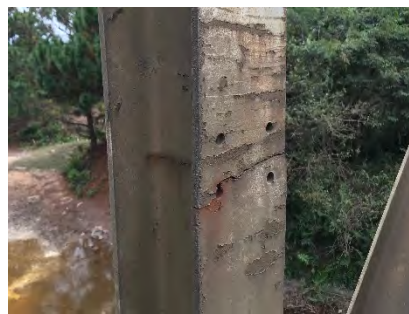
鉛直材のひび割れ
