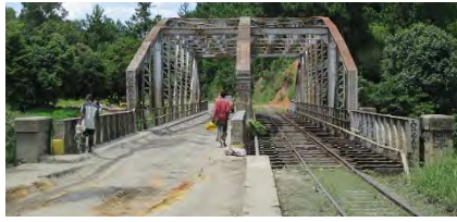
仮補修前（2018年2月）
