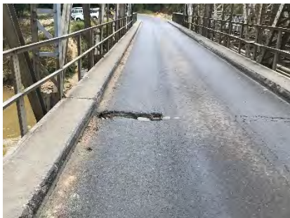
補修箇所の再損傷
