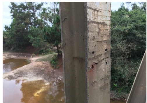
写真 18 トラス鉛直材のクラックが放置（2018年7月）
