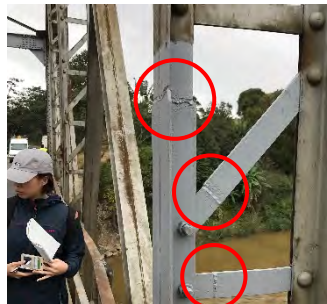
不完全な補修（溶接技術）
