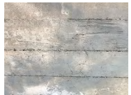
床版のひび割れ
