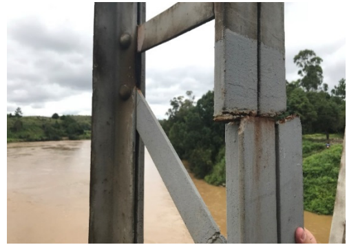
写真10 トラス鉛直部材の破断 (2019年3月)
