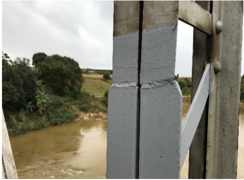
写真9 トラス鉛直部材の不適切な補修 (2018年7月)
