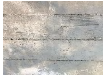
床版のひび割れ
