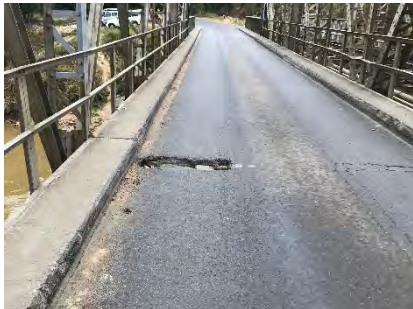
補修箇所の再損傷
