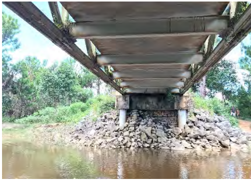
写真 17 橋台周囲の盛土流失。捨て石で補修（2018年7月）
