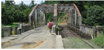
仮補修前（2018年2月）
