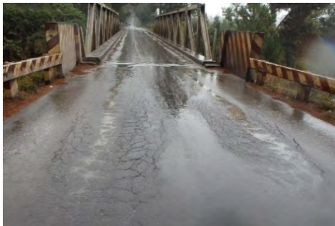
写真13 正面写真。路面のわだちに滞水する。（2018年7月）
