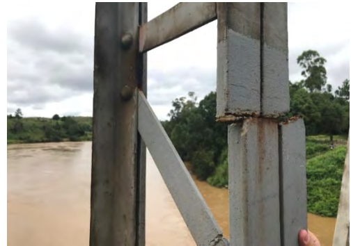
写真10 トラス鉛直部材の破断（2019年3月）
