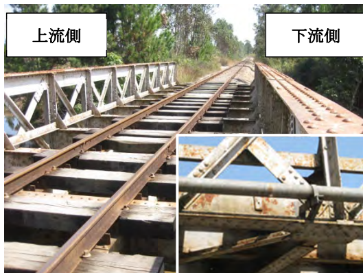
図 2-7 アンツァパザナ橋の通信ケーブル
