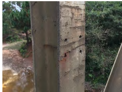
鉛直材のひび割れ
