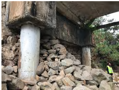
杭基礎の露出
