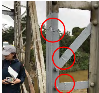
不完全な補修（溶接技術）
