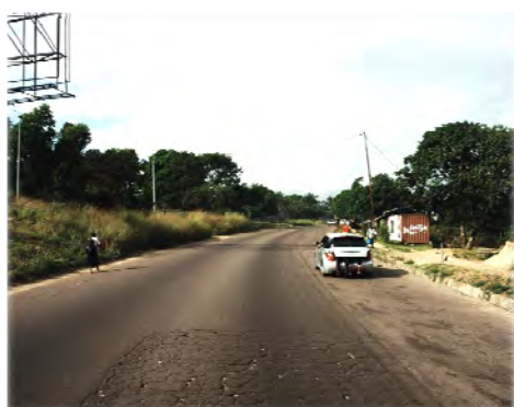
Fig 2.4. Vue des dégradations de la chaussée (fissures)
