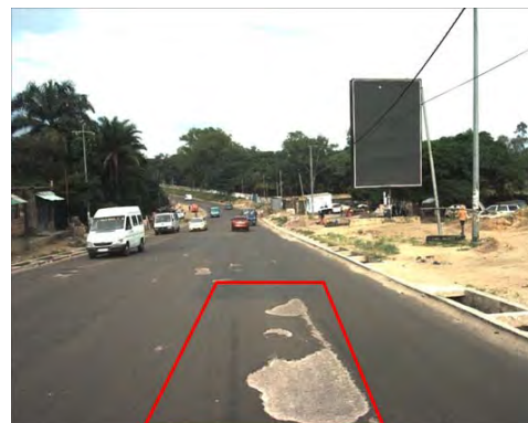
Fig 2.5. Vue des dégradations de la chaussée (Nids de poule)
