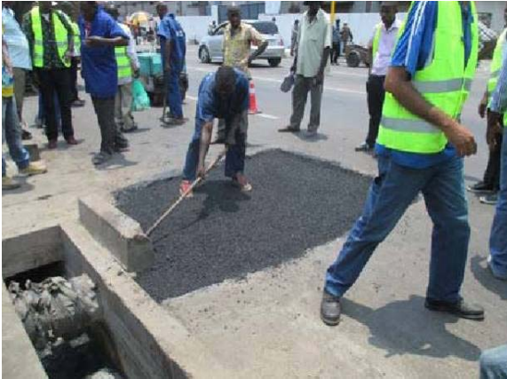
Formation sur le tas sur l'inspection des routes AP (Rapiéçage sur le Bd. Congo-Japon)
