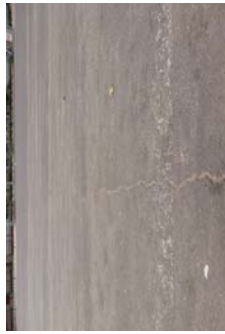
Figures 6.1.b. Fissures linéaires
