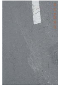
Figures 6.1.a. Fissures fines
