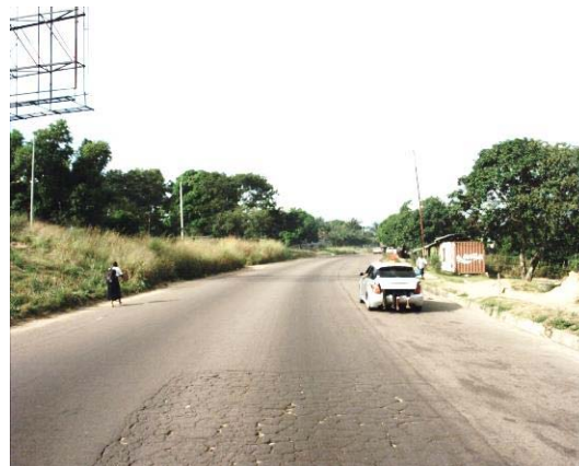
ランク 5 (Crack 80%以上)
