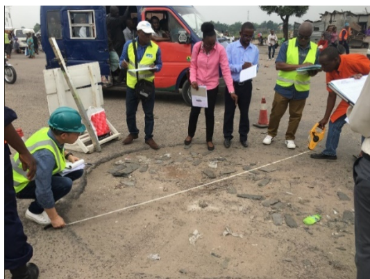
道路点検研修、ポットホール計測、損傷状況の記録 (2018/6/12)
