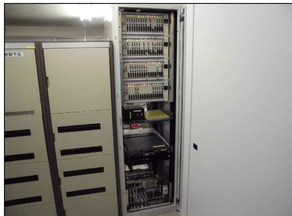
信号制御下位装置
