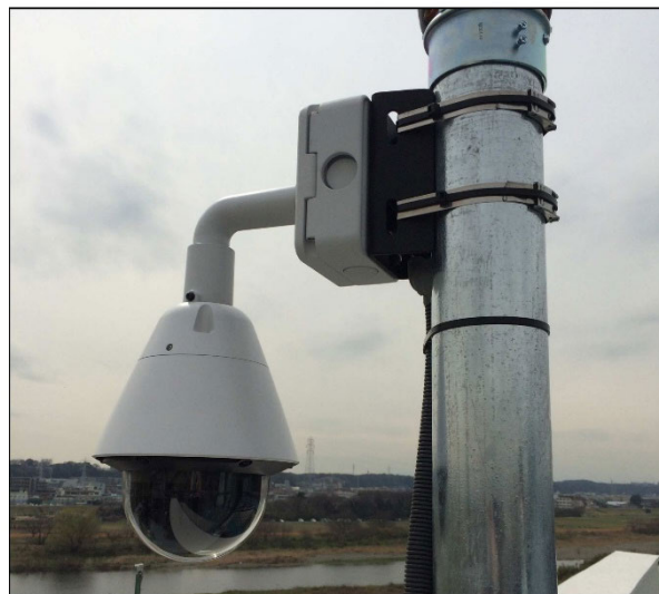
CCTV(今回対象外)
