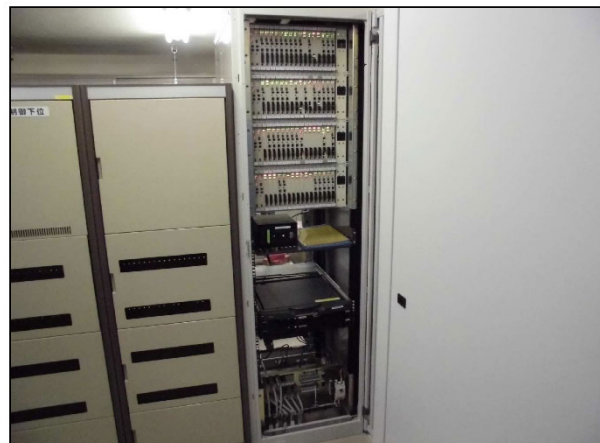
信号制御下位装置
