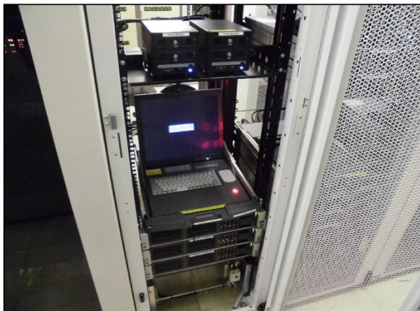
信号制御ブロック
