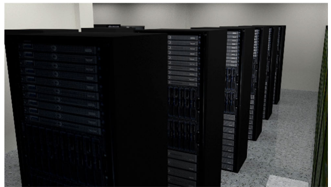
サーバールーム
