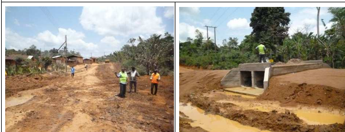
No.4+300 GOG 担当工事であるボックスカルバート完了 (3月20日)
