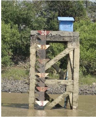
モンキーポイント既存潮位観測標 (2017年12月の崩壊前) (新規気象海象観測器設置位置)
